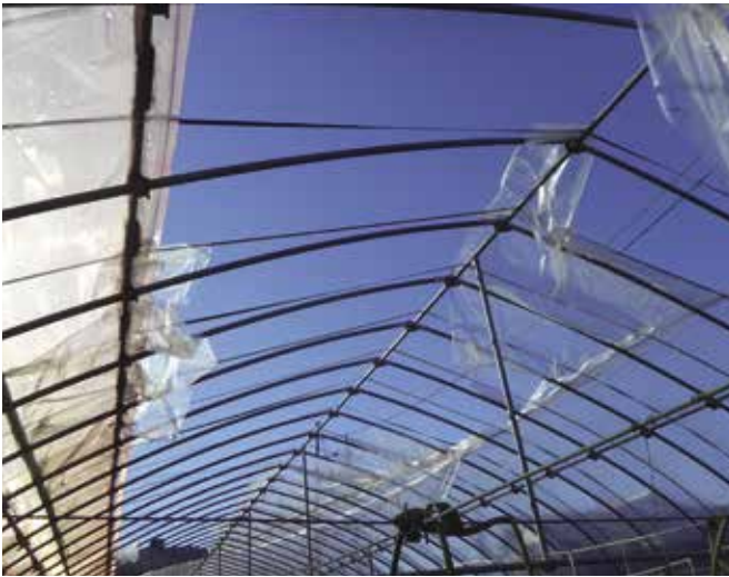
▲強風でビニールが破けた (深谷市)
